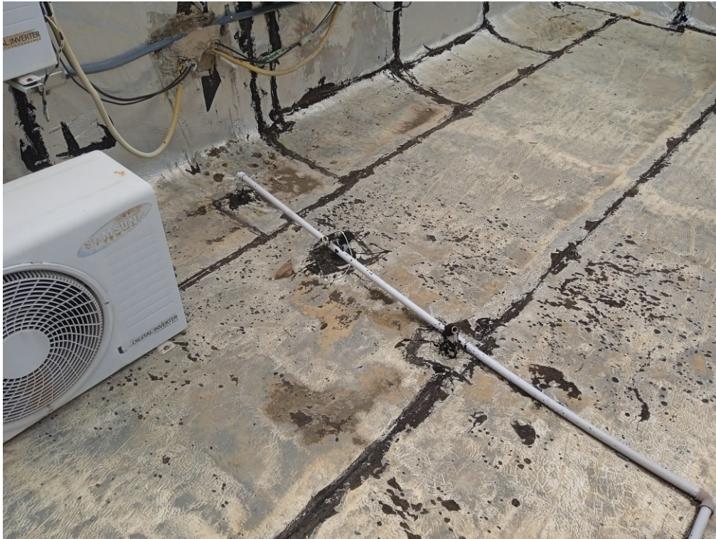
Figura 18 - Localização de eletroduto a ser vedado.
