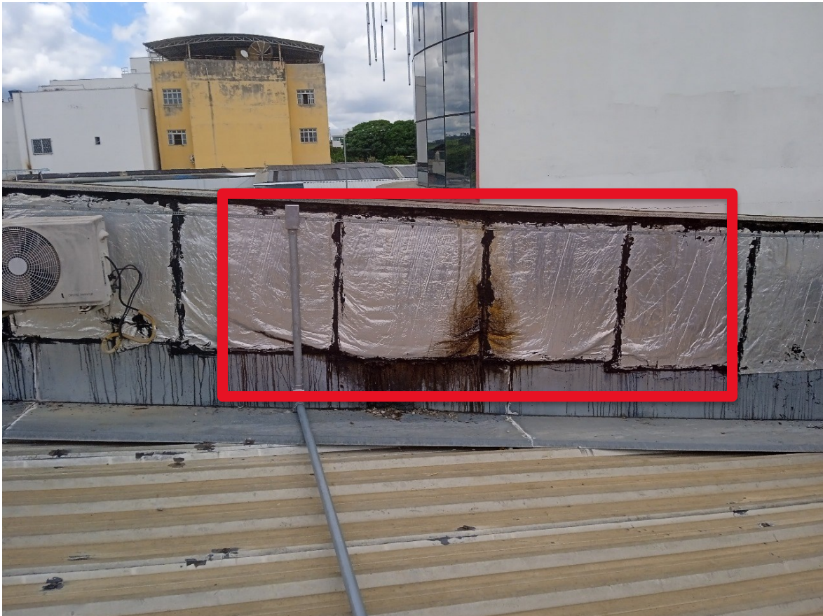
Figura 20 - Localização de manta com insetos a ser substituída.
