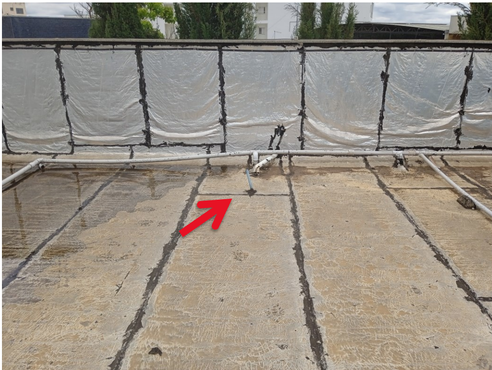
Figura 19 - Localização de eletroduto a ser vedado.
