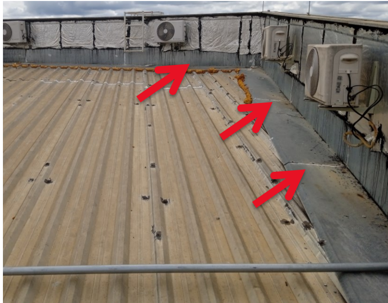
Figura 12 – Indicação de calhas e rufos a vedar com PU.
