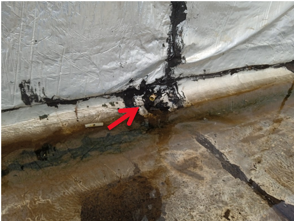
Figura 17 - Localização de eletroduto a ser vedado.
